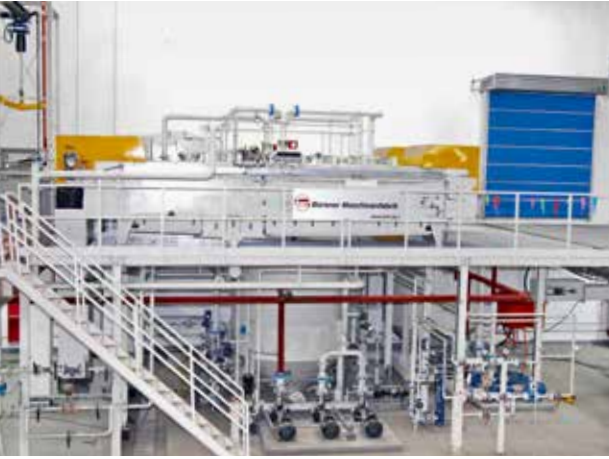
环保工厂——车间空气净化及空调装置
